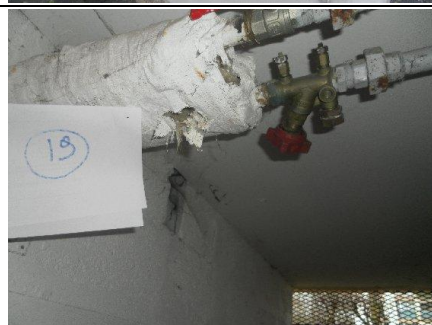
Photo n° PH06 Localisation : RDCH - Cave Ouvrage : Équipements divers et accessoires - Tuyauteries Partie d'ouvrage : Calorifugeages Description : Calorifugeages Localisation sur croquis : PH06
