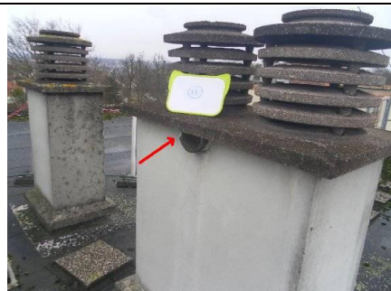
Photo n° PH02 Localisation : Toiture - Terrasse Ouvrage : Conduits, canalisations et accessoires intérieurs et extérieurs - Conduits de vapeur, fumée, échappement Partie d'ouvrage : Conduit Description : 4 canalisations d'évacuation des cheminées
